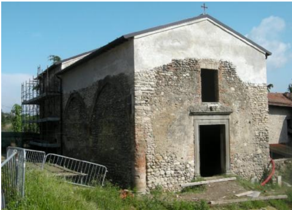
La pieve di San Bartolomeo è stata recentemente protetta dalle intemperie con un nuovo tetto
