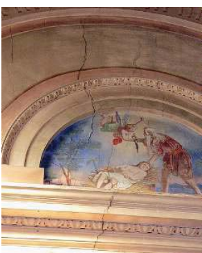
La fessurazione più importante nella chiesa
